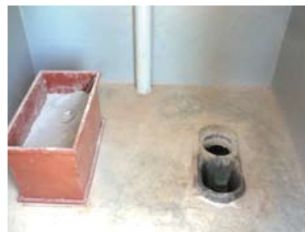
Toilette locale à séparation d'urines à Kyenjo. Photo : IRC
